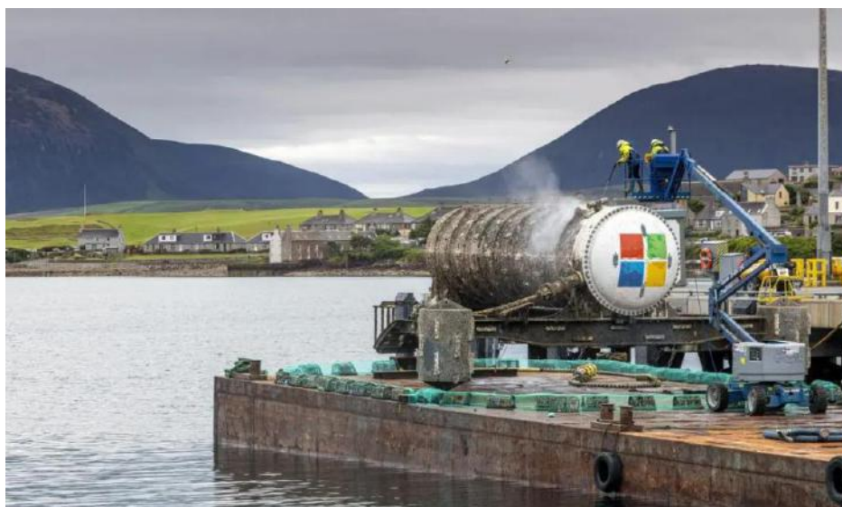
图表156： 建设在海边的水下数据中心
